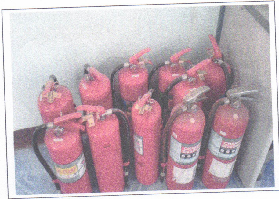
ถังดับเพลิงพร้อมใช้งาน
